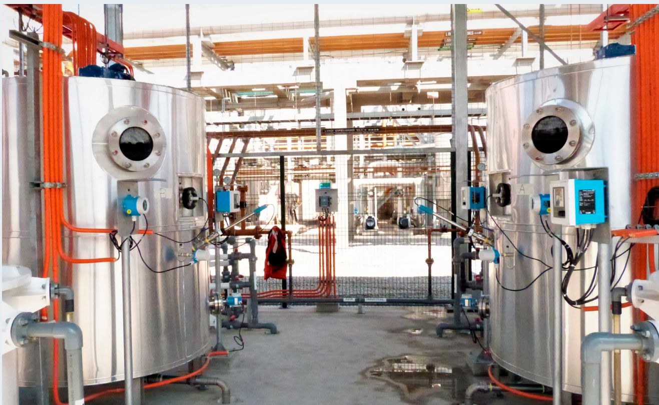
Plataforma piloto de digestión en la Biofactoria del Gran Santiago (Santiago de Chile)
