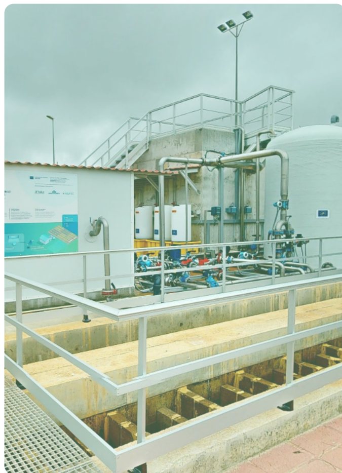
Imagen 1. Planta piloto de LIFE WARRIOR. A la izquierda la caseta donde se encuentran el sistema de desinfección mediante lámparas UV-LED y la herramienta digital, y a la derecha el sistema de membranas de UF reutilizadas.
